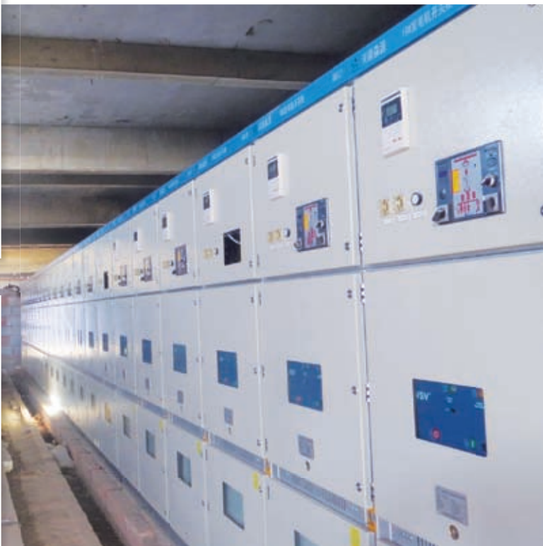
扬德环境与阳煤集团合资的新元瓦斯发电项目
