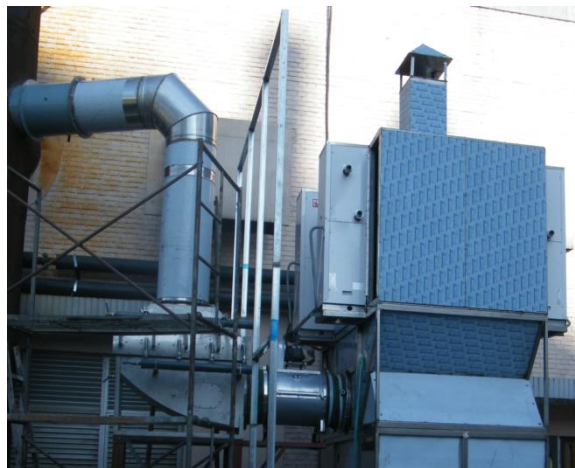
北京交通大学东校区锅炉房节能改造示范工程
