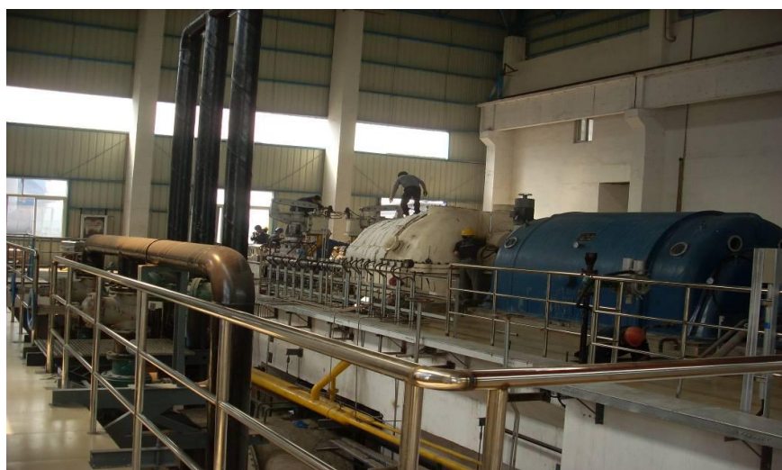
武汉都市环保公司兴建的 1x22MW 烧结余热发电工程
