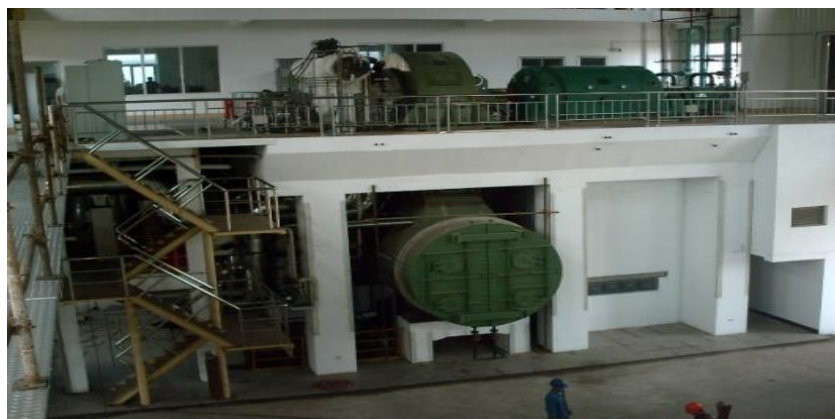
武汉都市环保公司兴建的 2x12MW 饱和蒸汽发电工程
