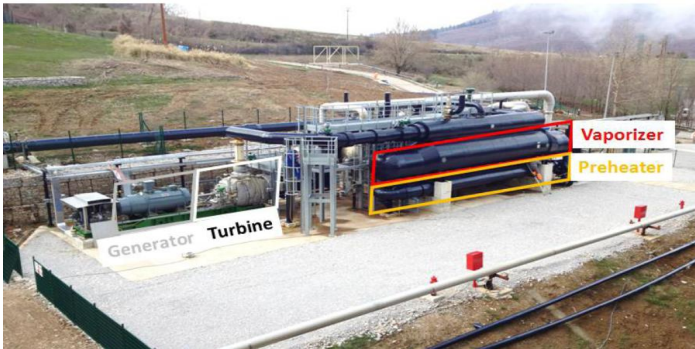
图5 Bagnore 双循环电厂
