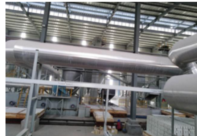
冷却窑预热引入干燥窑进风主管道
