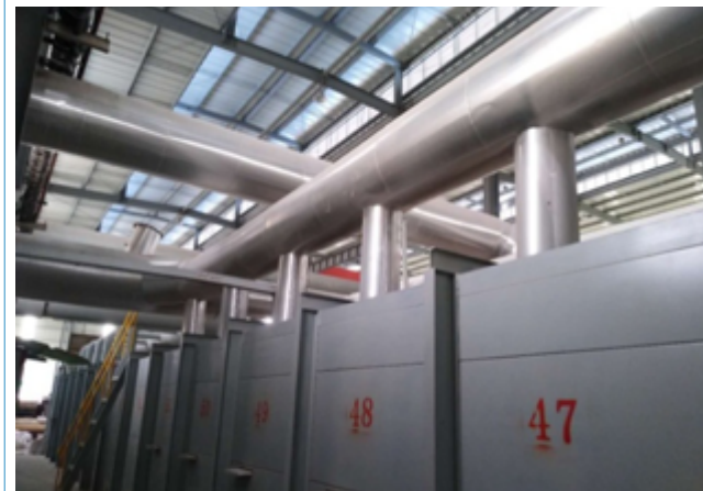
冷却带抽热风管进入风机进风管
